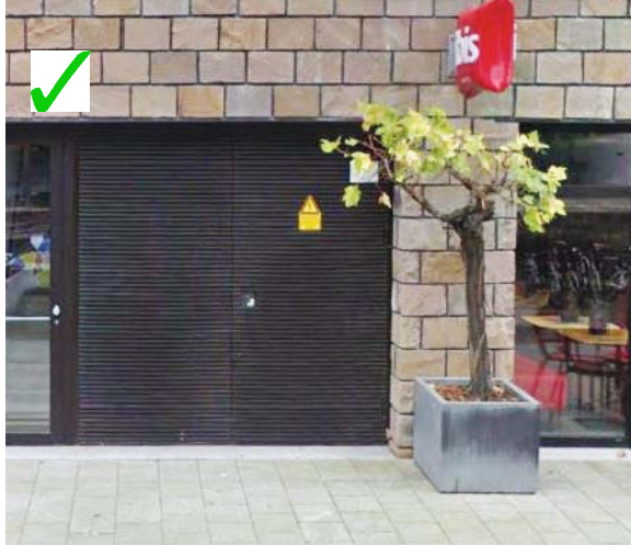
Transformatorruimte passend opgelost in de gevel.
